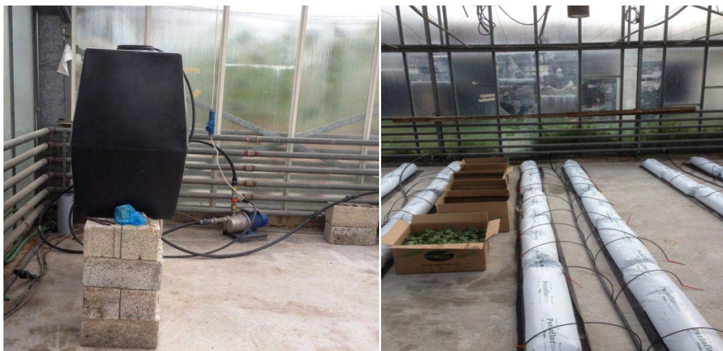
Εικόνα 2.3 Δεξαμενή, αντλία νερού, σωληνώσεις πολυαιθυλενίου, σταλάκτες
