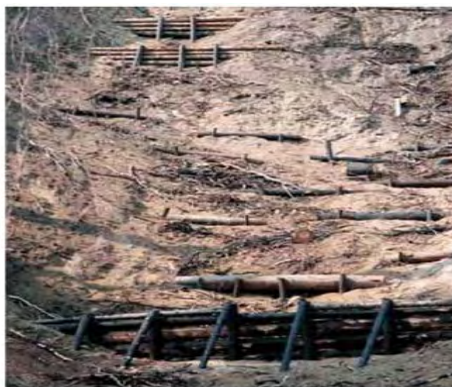
Εικόνα 31. «Κορμοφράγματα» για τη στερέωση του εδάφους σε παλαιά γεωλίθηση που δημιουργήθηκε βαθμιαία μετά τη μεγάλη πυρκαγιά του 1932
