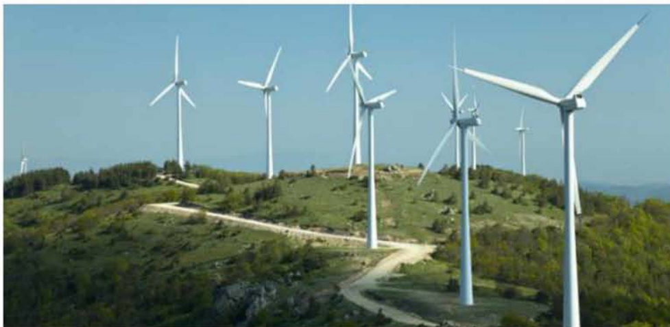
Εικόνα 5 : Χερσαίο αιολικό πάρκο
