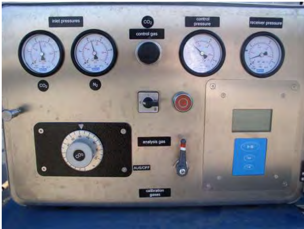
Εικόνα 5.4.3.2. Ο πίνακας ελέγχου του μίκτη αερίων
