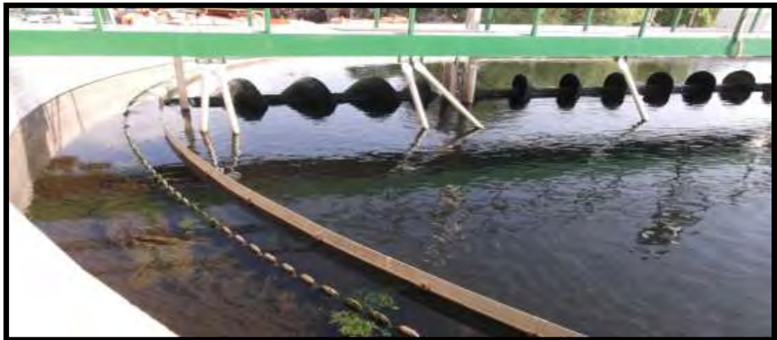
Εικόνα 16: Άλγη-φύκια στην υπερχείλιση της δεξαμενής καθίζησης.
