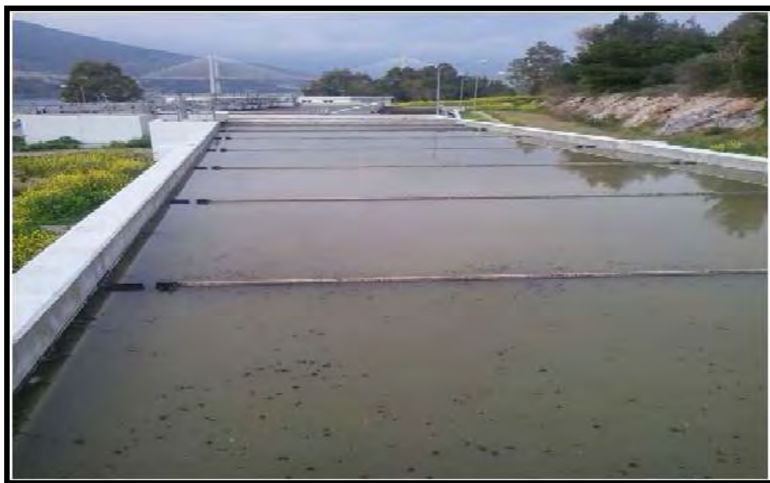
Εικόνα 10: Ορθογώνια δεξαμενή πρωτοβάθμιας καθίζησης.
