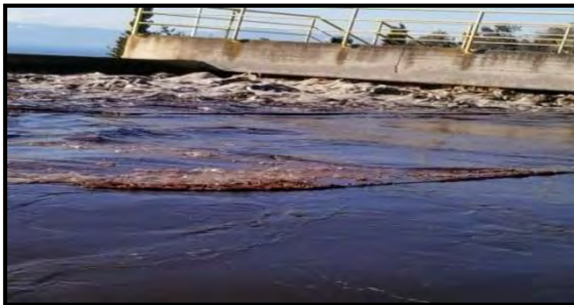
Εικόνα 13: Δεξαμενή αερισμού με επιφανειακό αερισμό. Υψηλός δείκτης F:M.
