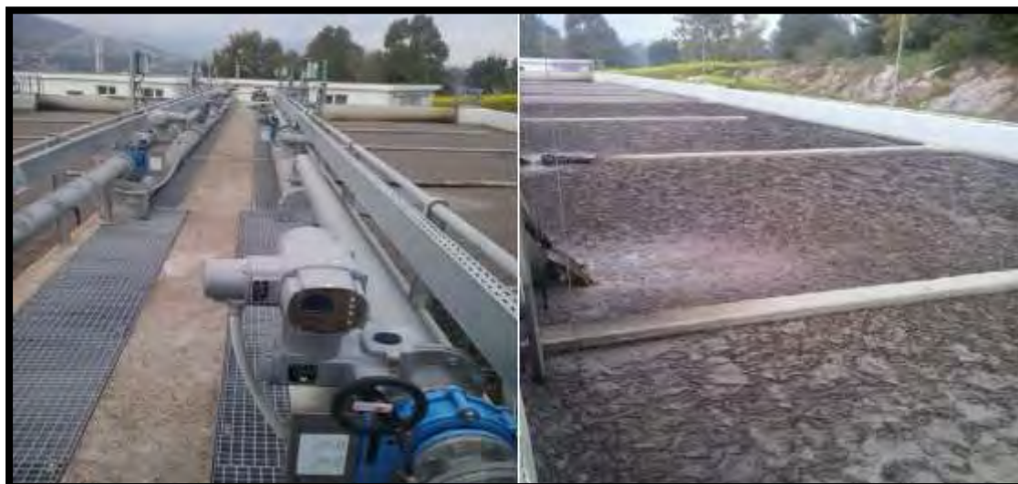
Εικόνα 11: Δεξαμενή αερισμού με φυσητήρες. Χαμηλός δείκτης F:M
