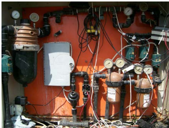
Εικόνα 5.14 Μηχανολογικός εξοπλισμός φυλασσόμενος σε ειδικά διαμορφωμένο κουτί
