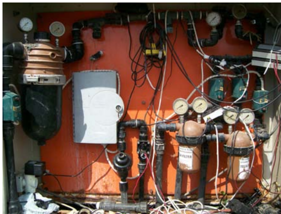
Εικόνα 5.14 Μηχανολογικός εξοπλισμός φυλασσόμενος σε ειδικά διαμορφωμένο κουτί
