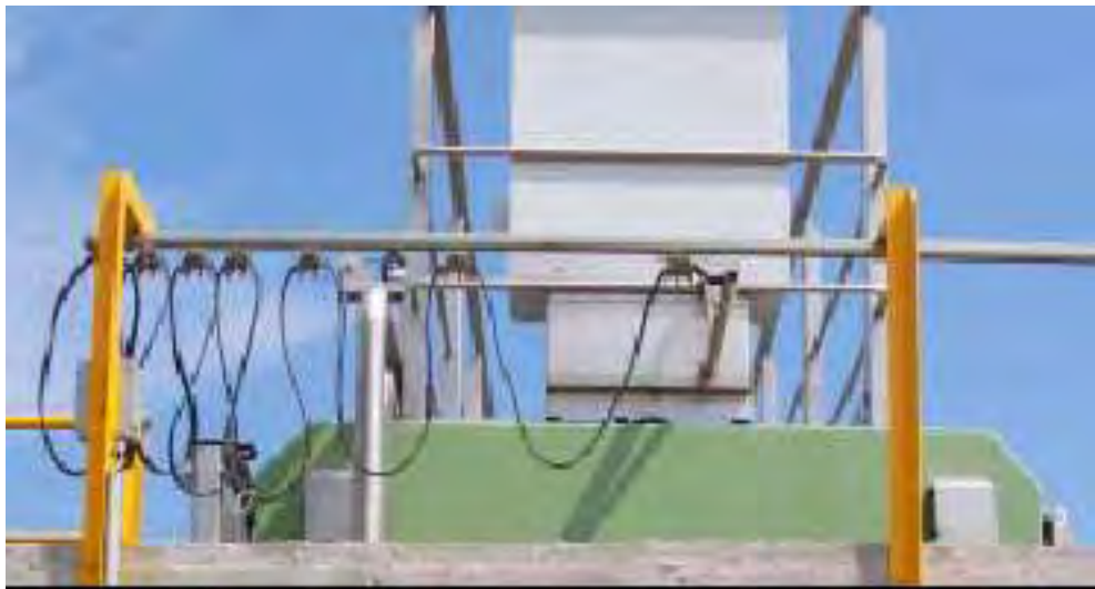
Εικόνα 37 Παλινδρομική γέφυρα , με ανοξειδωτα ξέστρα πυθμένος και επιφανείας για τη σάρωση και συλλογή άμμου και λιπών .
