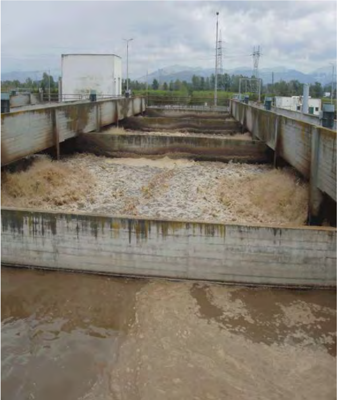
Εικόνα 9. Δεξαμενή Αερισμού 2.2.1.5 Τρποβάθμια Επεξεργασία
