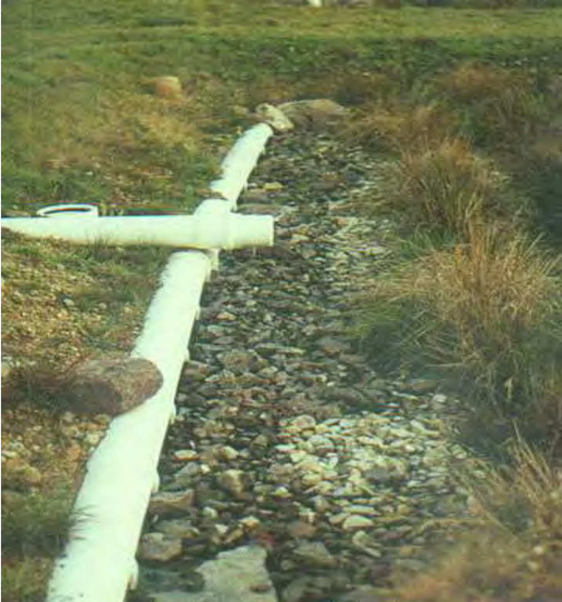
Εικόνα 22. Τεχνητός υγρότοπος Υπόγειας ροής (SSF) – Είσοδος
