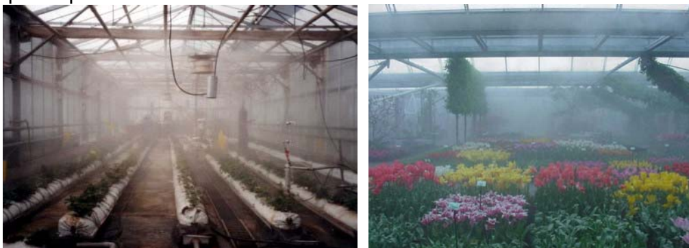
Εικόνα 6. Σύστημα τεχνητής ομίχλης.
