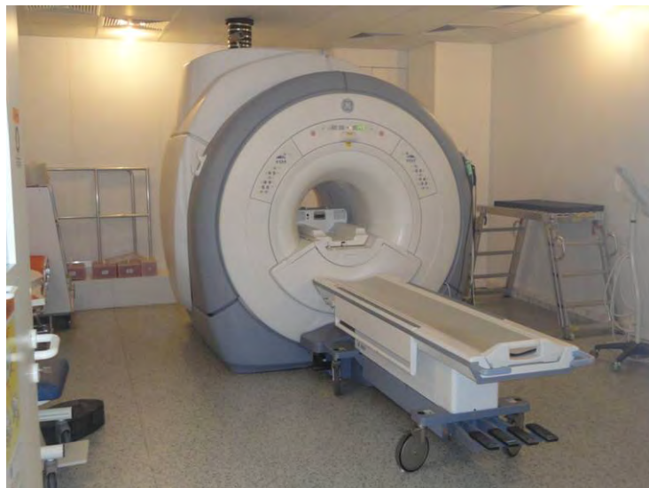
Εικόνα 5.1.1 Σύστημα Μαγνητικής Τομογραφίας υψηλού πεδίου 3T εγκατεστημένο στο Πανεπιστημιακό Γενικό Νοσοκομείο Λάρισας.
