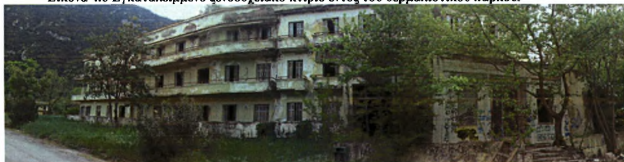
Εικόνα 4.6 Εγκαταλειμμένο ξενοδοχειακό κτίριο εντός του θερμαλιστικού πάρκου.
