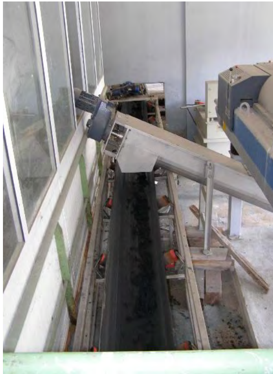
Εικόνα 2.7: Ταινιόδρομος μεταφοράς της λυματολάσπης.
