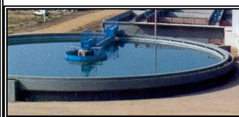
Σχήμα 2.3: Δευτεροβάθμια δεξαμενή καθίζησης
