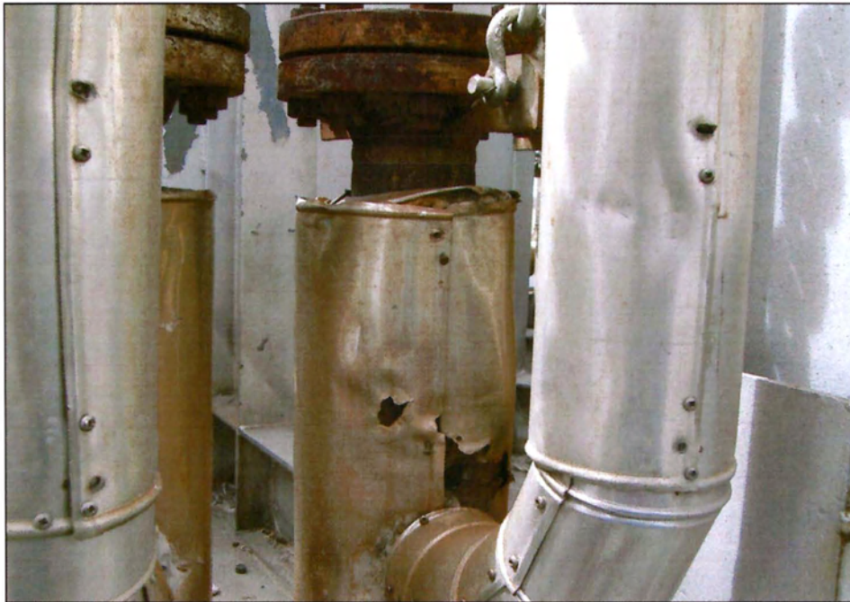
Εικόνα 3.2: Διαρροή από τον αυλό που αστόχησε
