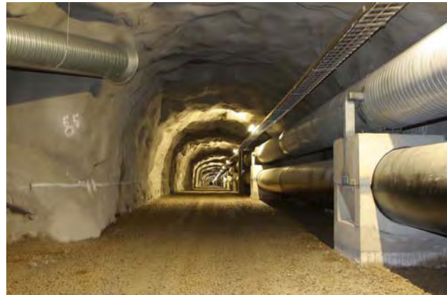
Εικόνα 17: Σήραγγα δικτύων κοινής ωφέλειας στο Ελσίνκι (Πηγή: City of Helsinki)
