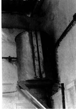
10. Δεξαμενή ημερήσιας κατανάλωσης πετρελαίου
