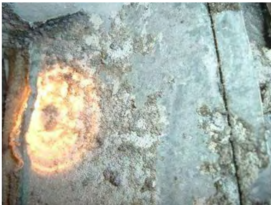
Εικόνα 9. Ανάπτυξη μούχλας σε αεραγωγό δικτύου κλιματισμού (Πηγή: http://www.moldinspector.com )
