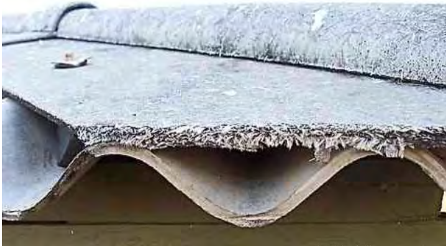
Εικόνα 2. Επικίνδυνες ίνες αμιάντου σε φύλλο επικάλυψης στέγης από αμιαντοτσιμέντο. (Πηγή: www.builderbill-diy-help.com ).
