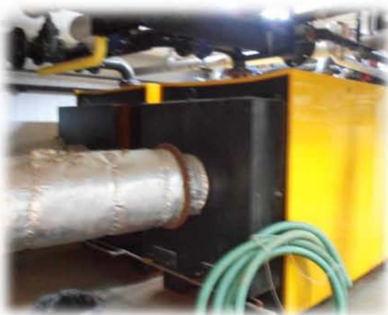
Εικόνα 2.15 Δύο λέβητες πετρελαίου εκτός λειτουργίας.
