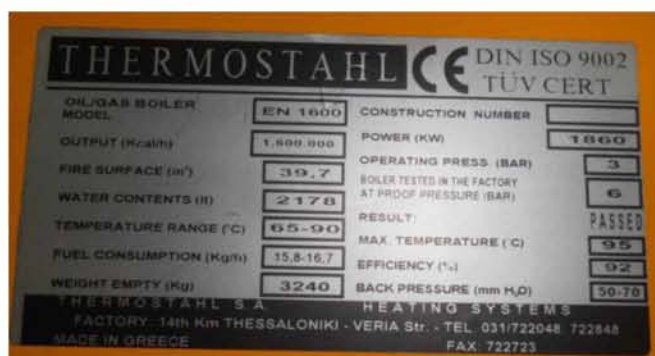
Εικόνα 2.7 1 ος Λέβητας αερίου εξωτερικής πισίνας ισχύος 1860 kW.
