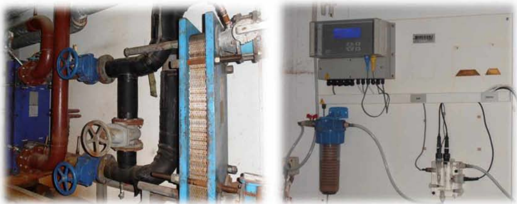
Εικόνα 2.11 Εναλλάκτες θερμότητας και σύστημα χλωρίωσης πισίνας.
