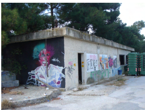
Εικ. 114: Κτίσμα Κ6, προτείνεται η κατεδάφισή του.
