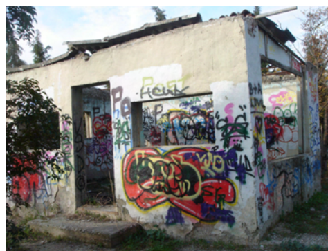
Εικ. 125: Κτίσμα K32, προτείνεται η κατεδάφισή του.
