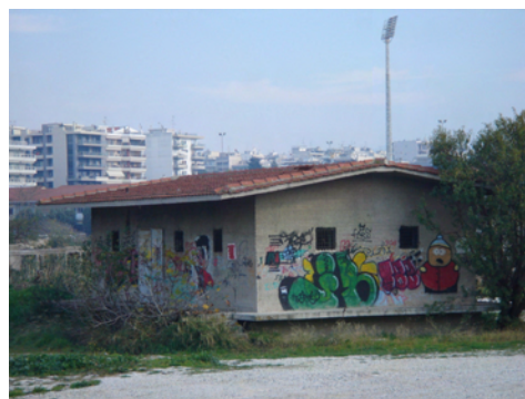
Εικ. 115: Κτίσμα Κ11, προτείνεται η κατεδάφισή του.
