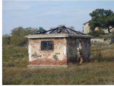
Εικ. 123: Κτίσμα K27, προτείνεται η κατεδάφισή του.
