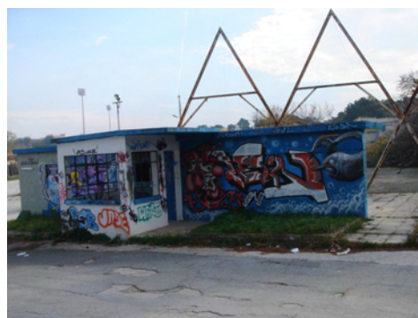
Εικ. 117: Κτίσμα Κ13, προτείνεται η κατεδάφισή του.
