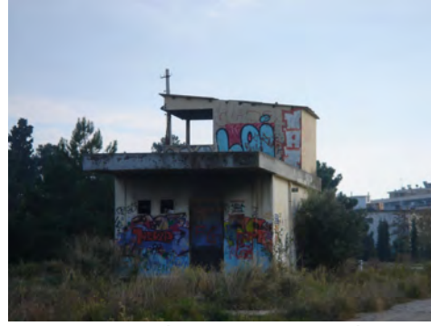
Εικ. 122: Κτίσμα K24, προτείνεται η κατεδάφισή του.
