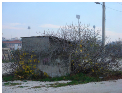
Εικ. 116: Κτίσμα Κ12, προτείνεται η κατεδάφισή του.
