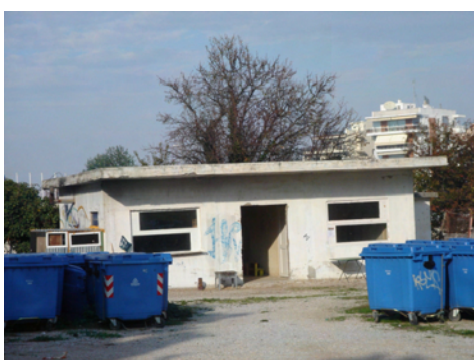
Εικ. 113: Κτίσμα Κ5, προτείνεται η κατεδάφισή του.
