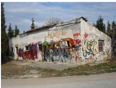
Εικ. 124: Κτίσμα K31, προτείνεται η κατεδάφισή του.
