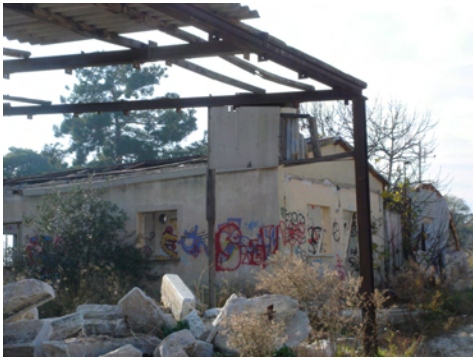
Εικ. 119: Κτίσμα K20, προτείνεται η κατεδάφισή του.
