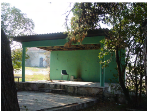
Εικ. 112 : Κτίσμα Κ4, προτείνεται η κατεδάφισή του.
