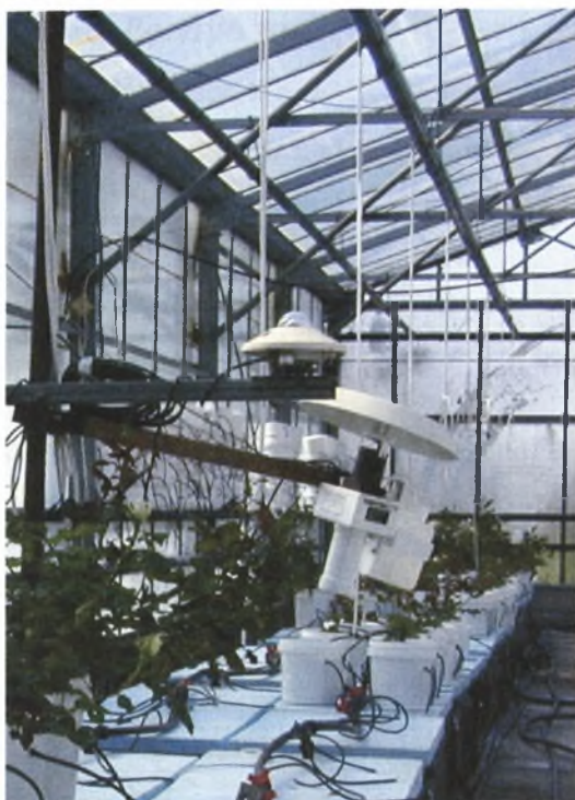
Εικόνα 17. Όργανα μετρήσεων κλιματικών παραγόντων εντός του θερμοκηπίου
