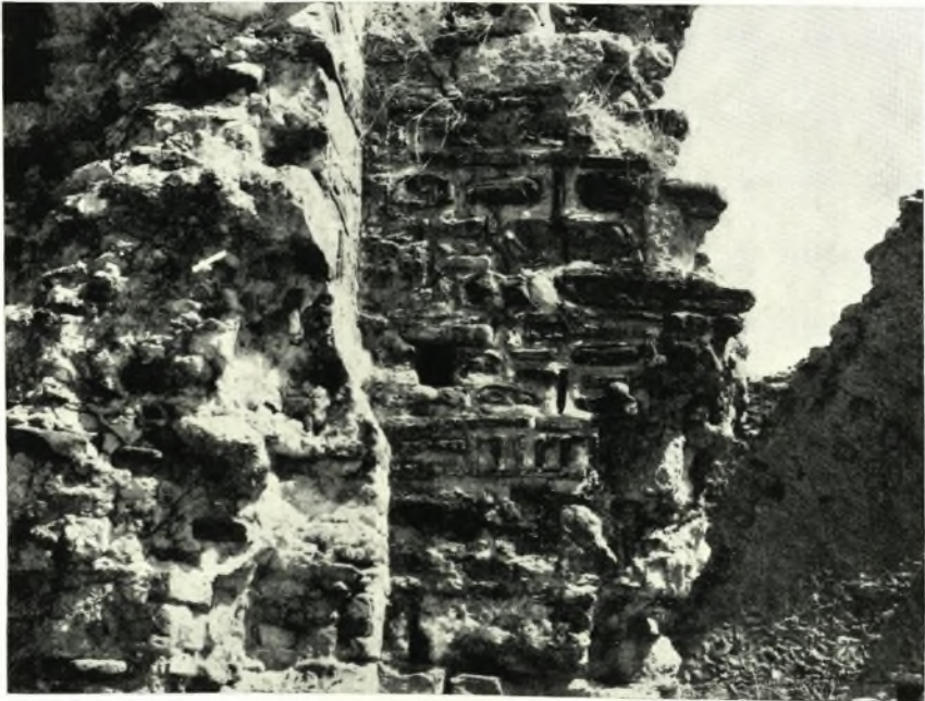
β. "Άγιος Λέων Μεθώνης. Τοιχοδομία τῆς νοτίας ὄψεως (ἀριστερὰ τοῦ νοτίου ἀνοίγματος).
