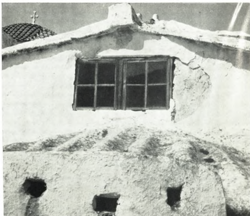
α. Τὸ ὑπεράνω τῆς ἀψίδος τοῦ Ἁγ. Νικολάου ἀνοιγμα πρὸ τῶν ἐργασιῶν ἀποκαταστάσεως αὐτοῦ.
