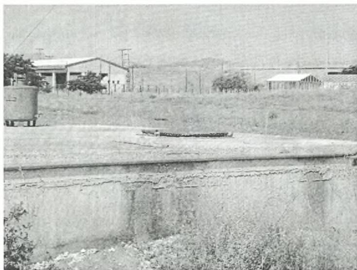
Εικόνα 5.20. Δεξαμενή συγκέντρωσης καθαρού νερού άρδευσης.
