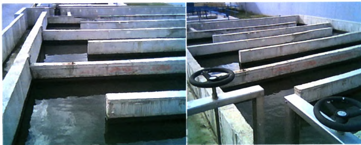
Σχήμα 4.5: Δεξαμενή χλωρίωσης ΕΕΑ Δήμου Αλμυρού και ευρείας περιοχής
