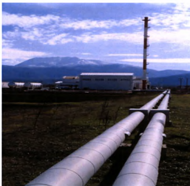
Εικόνα 22: Δίκτυο τηλεθέρμανσης στην Κοζάνη
