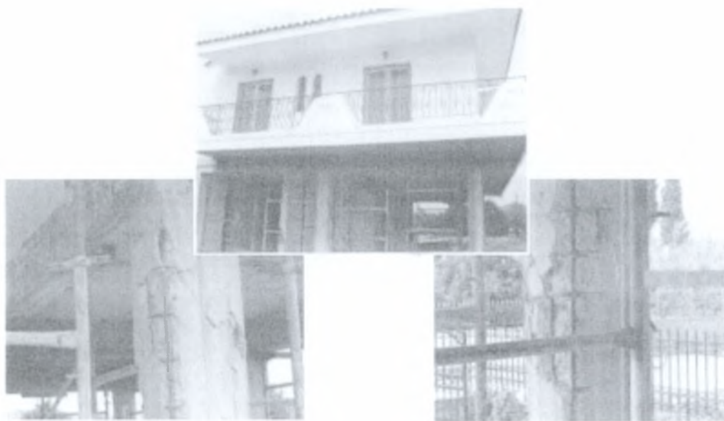
Εικόνα 1.2.2 Αστοχία σε υποστυλώματα πιλοτής
