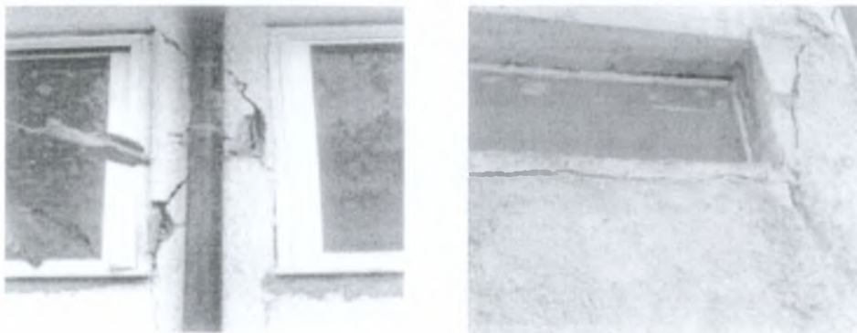
Εικόνα 1.3. 2 Βλάβες διατμητικού χαρακτήρα σε κοντά υποστυλώματα (Βαρθολομίο 12/2002)
