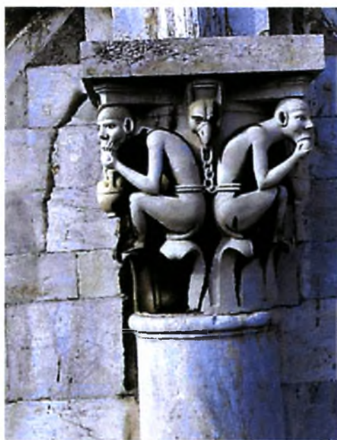
Μαύρη κρούστα σε προφυλαγμένη περιοκή μνημείου, η οποία προκαλεί ένα αποτέλεσμα εξαιρετικά αντιαισθητικό (Πολυκρέτη, 2000).
