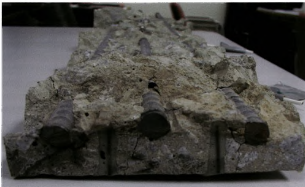
Σχήμα 3.27 Αποκολλούμενο τμήμα της δοκού
