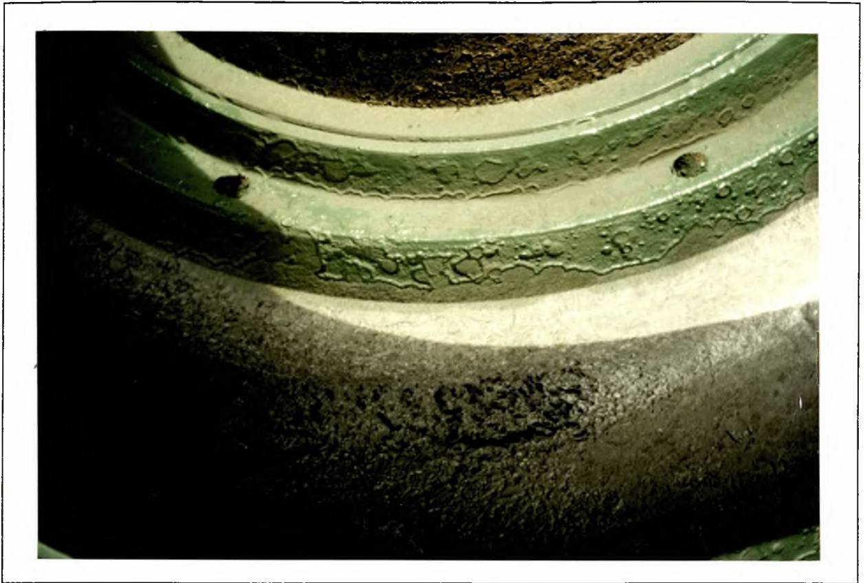
Φώτο. 5: Διάβρωση του εσωτερικού της αντλίας Fonte á Cr.
