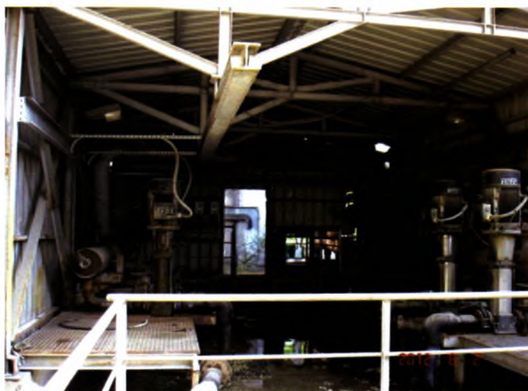
Εικόνα 30: Φωτογραφία του αντλιοστασίου του εργοστασίου
