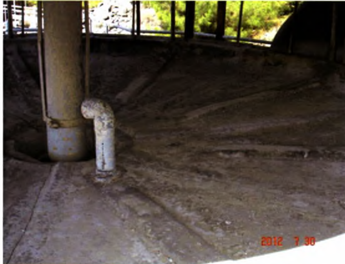
Εικόνα 36: Λεκάνη απορροής πύργου ψύξης-διακρίνονται οι επικαθίσεις στην επιφάνεια της λεκάνης
