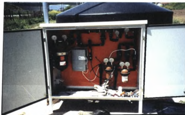
Πίνακας Ελέγχου του αρδευτικού συστήματος
