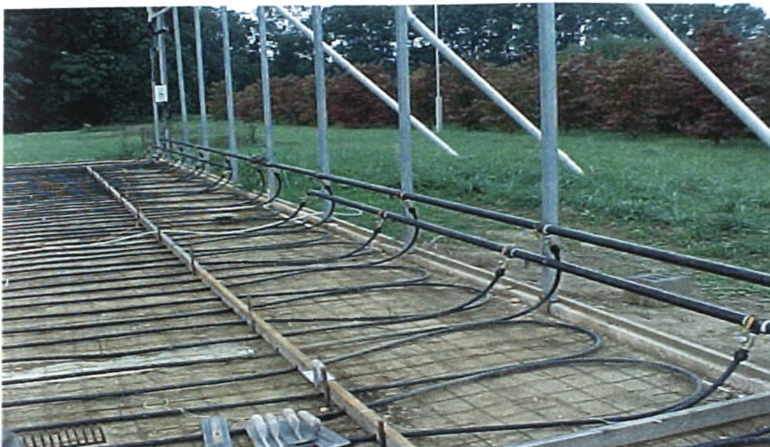
Εικόνα 1.11. Κεντρικό Σύστημα Θέρμανσης
