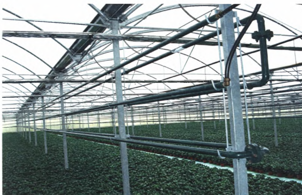
Εικόνα 1.10. Κεντρικό Σύστημα Θέρμανσης
