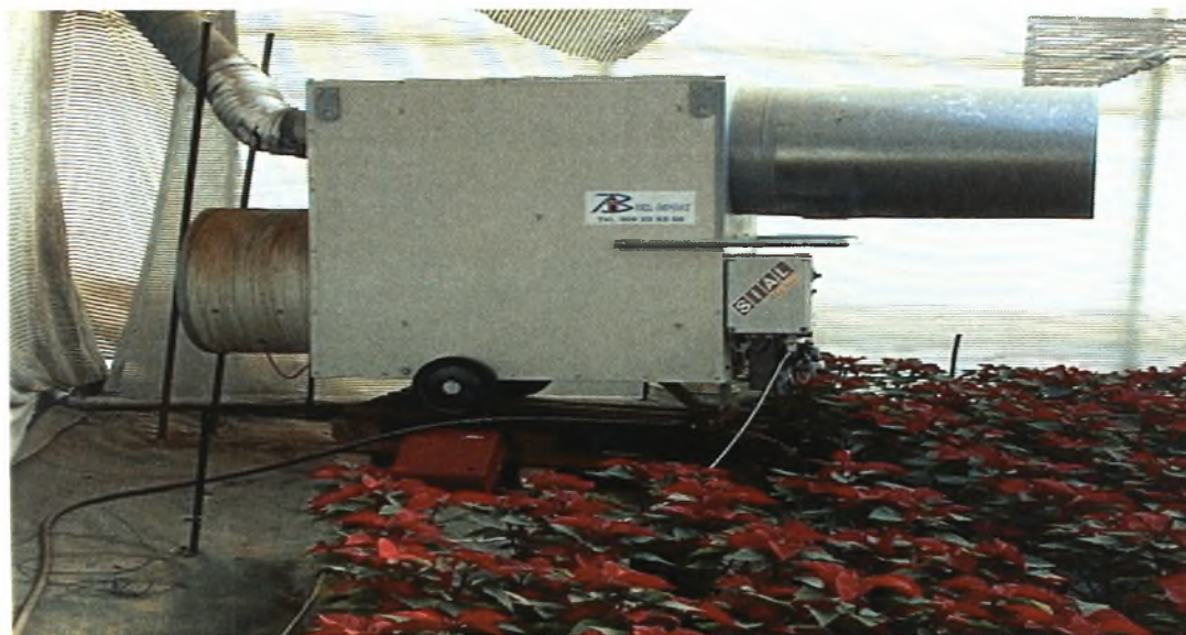
Εικόνα 1.7. Αερόθερμα. Το κεντρικό σύστημα απ' όπου προέρχεται ο ζεστός αέρας
