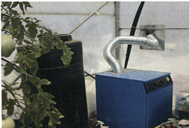
Εικόνα 3.3 Άποψη του λέβητα στο εσωτερικό του θερμοκηπίου καθώς και του συστήματος απαγωγής των καυσαερίων και της δεξαμενής του πετρελαίου.
