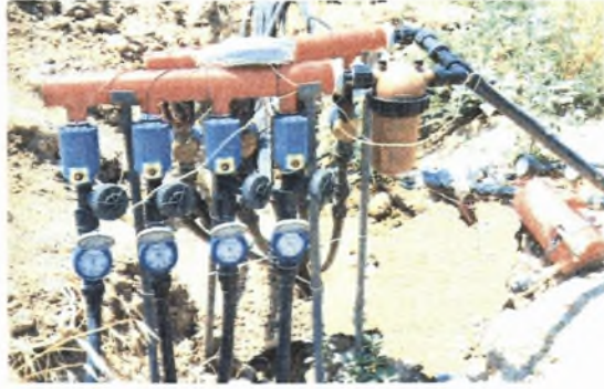
Φωτογραφία 3. Η μονάδα ελέγχου όπως ήταν τοποθετημένη στον πειραματικό αγρό στο Βελεστίνο όπου φαίνονται ο προγραμματιστής, οι ηλεκτοβάνες με τους υδρομετρητές και το φίλτρο σίτας.
