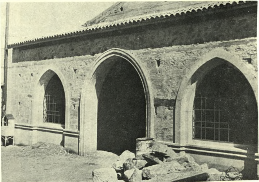
Κρήτη: α. Μπιζαριανώ Πεδιάδος. Ναός Ἁγίου Παντελεήμονος. Νοτία ὄψις πρὸ τῶν ἐργασιῶν ἀποκαταστάσεως, β. Ἡράκλειον. Παναγία τῶν Σταυροφόρων. Δυτική ὄψις προστώου
