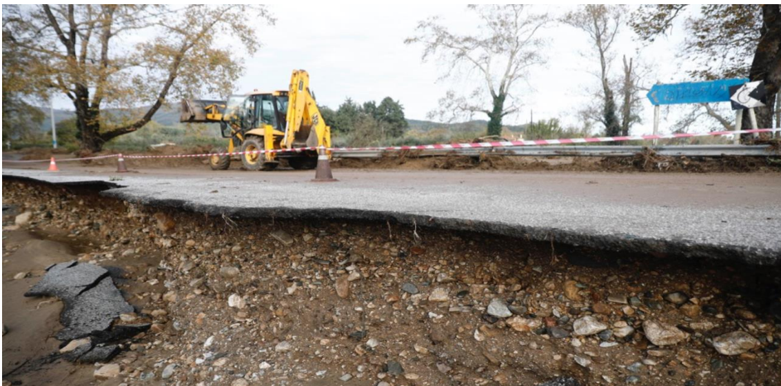
Εικόνα 3.15 Επιπτώσεις της πλημμύρας στο οδικό δίκτυο της Ολυμπιάδας Χαλκιδικής ( https://www.ekathimerini.com/multimedia/images/246799/flooding-damages-roads-in-halkidiki/ ).
