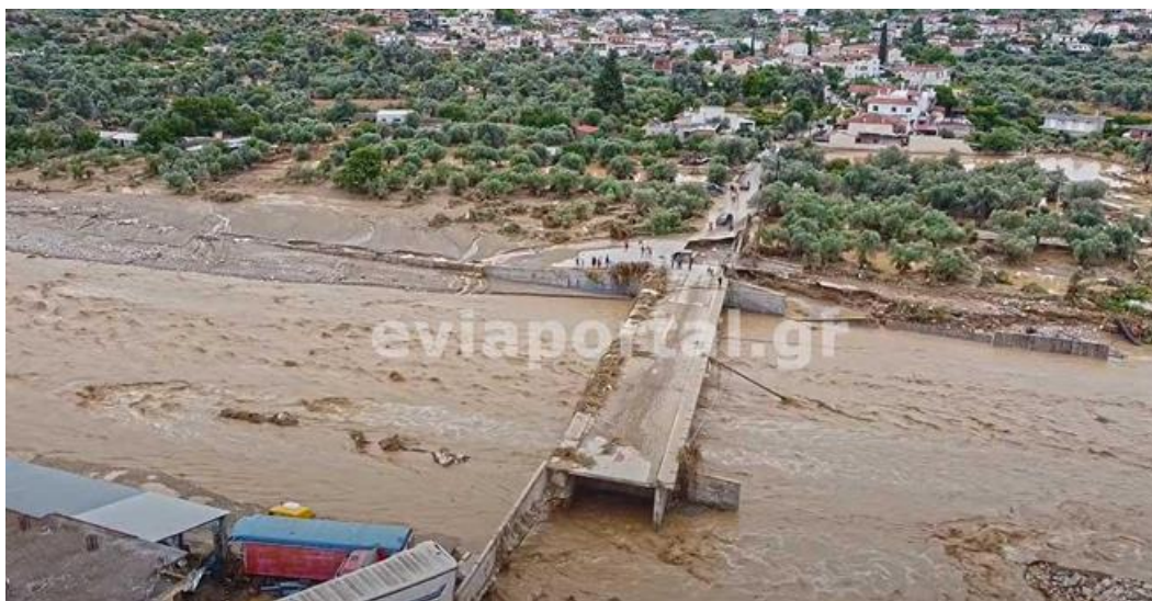
Εικόνα 3.12 Εκτεταμένες ζημιές στην γέφυρα Αφρατίου από τα ορμητικά νερά του Λήλαντα (Σπυριδάκης 2020).
