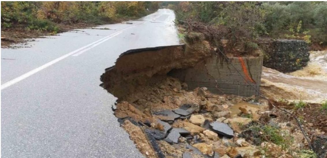
Εικόνα 3.16 Καταστροφή τμήματος του οδικού δικτύου Ολυμπιάδας Χαλκιδικής ( https://halkidikivoice.gr/halkidiki/item/6074-provlhmata-apo-plhmmmyrika-fainomena-olympiada ).
