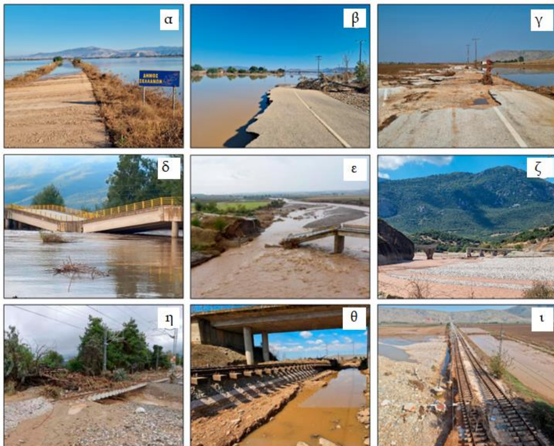
Εικόνα 3.6 Οι επιπτώσεις της κακοκαιρίας Ντάνιελ στις συγκοινωνιακές υποδομές. (α) πλήρης κάλυψη του οδοστρώματος από τα πλημμυρικά ύδατα, (β) αποκόλληση τμημάτων του οδοστρώματος λόγω υποσκαφής από τη ροή του νερού, (γ) φθορές στο οδόστρωμα εξαιτίας της έντονης ροής υδάτων σε συνδυασμό με φερτά υλικά, (δ) η γέφυρα του Πηνειού στον Παλαιόπυργο, (ε) η γέφυρα του Ενιπέα στην Καρδίτσα, καθώς και (ζ) η ιστορική γέφυρα Γερακίνας στα Τρίκαλα υπέστησαν ζημιές, (η) απόθεση φερτών υλών που σκέπασε τμήματα γραμμών, (θ) διάβρωση του εδάφους κάτω από τις σιδηροτροχιές και η παραμόρφωσή τους, (ι)
