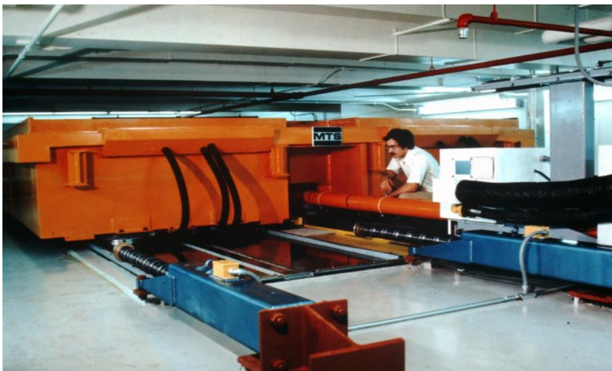
Εικόνα 5: Αποσβεστήρας συντονισμένης μάζας του John Hancock Tower.
