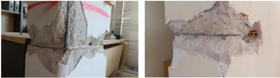
Σχήμα 2.19. Αποκάλυψη οπλισμού υποστυλωμάτων
