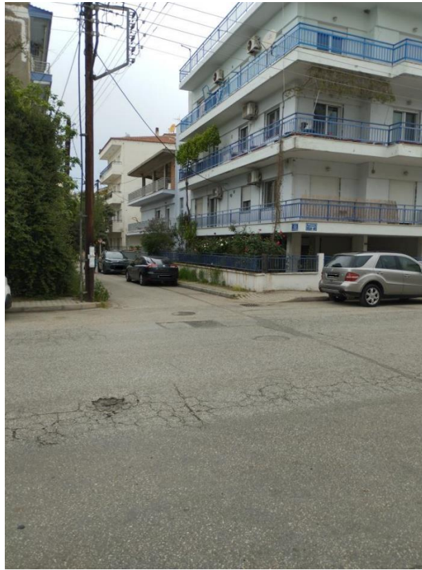
Εικόνα 37 Ράμπα στο πεζοδρόμιο με έλλειψη οδηγού όδευσης
