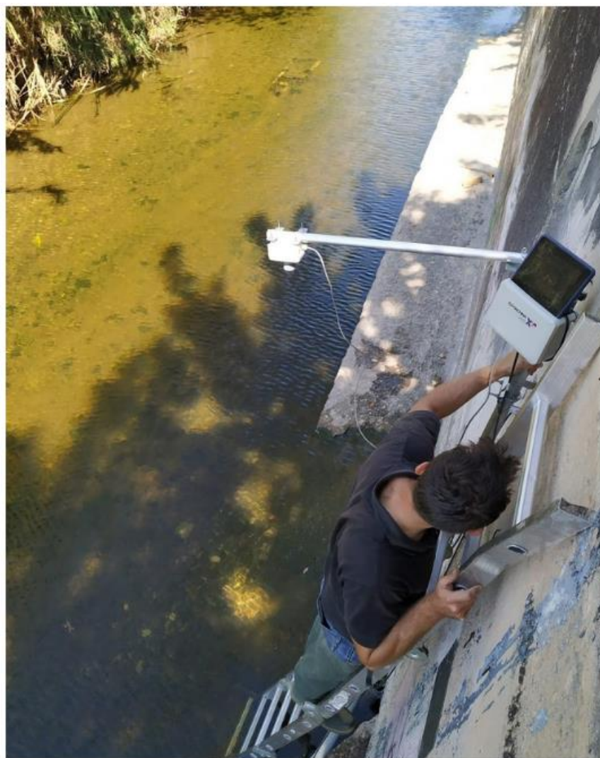
Εικόνα 2.11 Τοποθέτηση αισθητήρα για την παρακολούθηση υδάτων από την εταιρία EXMACHINA [8]
