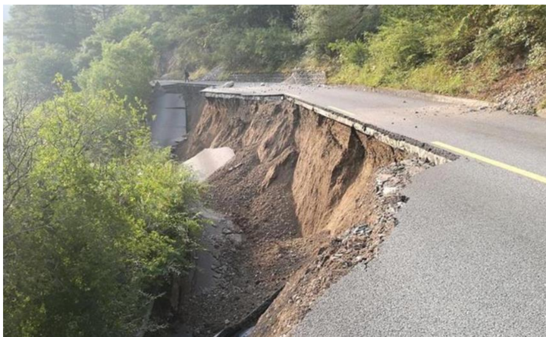
Εικόνα 2.6. Αστοχία πρανούς που σημειώθηκε λόγω σεισμού στην επαρχία Σιτσουάν της Κίνας το 2008.Πηγή:yicaiglobal.com
