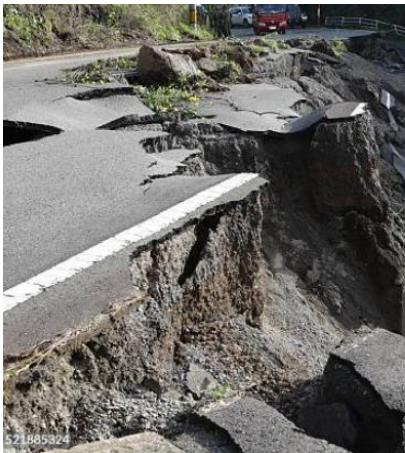
Εικόνα 2.5. Αστοχία πρανούς στην Ιαπωνία λόγω σεισμού το 2018 (μέγεθος 5,6 R, βάθος 13 χιλιομέτρων με επίκεντρο κοντά στην πόλη Τακατσούκι).Πηγή:news.sky.com
