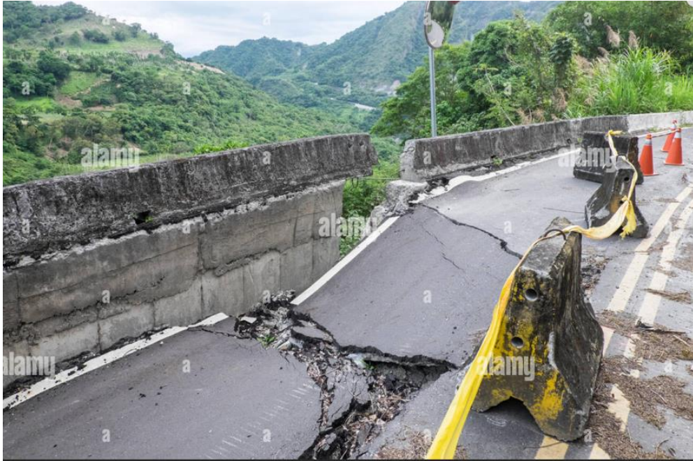
Εικόνα 2.3. Αστοχία πρανούς λόγω σεισμού στην Ταιβάν το 2018. Σεισμός μεγέθους 6,4 R με επίκεντρο κοντά στην γραμμή Χουαλιέν και βάθος 10,6 χιλιόμετρα. Πηγή alamy.com
