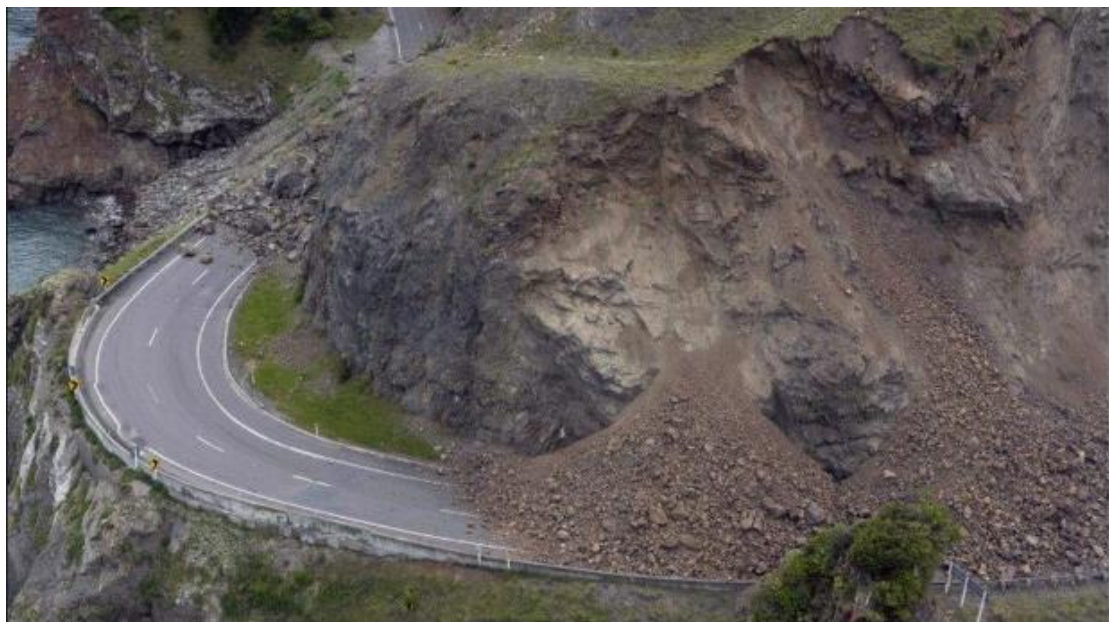
Εικόνα 2.4. Αστοχία πρανούς λόγω σεισμού στη Νέα Ζηλανδία το 2016 (Μέγεθος 7,8 R), Πηγή: ABC News
