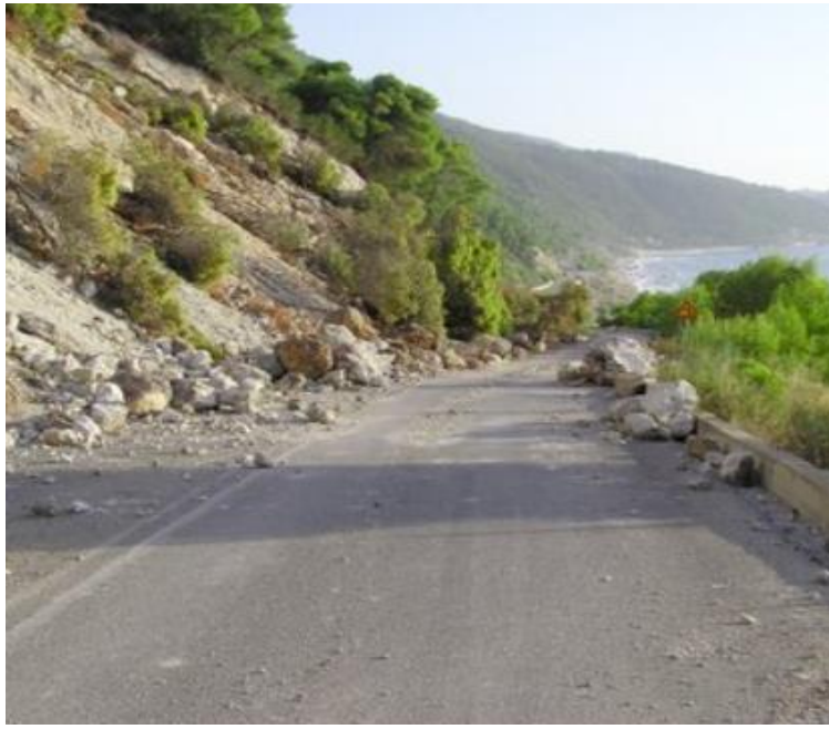
Εικόνα 2.2. Αστοχία πρανούς κατά τον σεισμό στην Κεφαλονιά το 2014 (μέγεθος 5.8 R) Πηγή: researchgate.net/fig4
