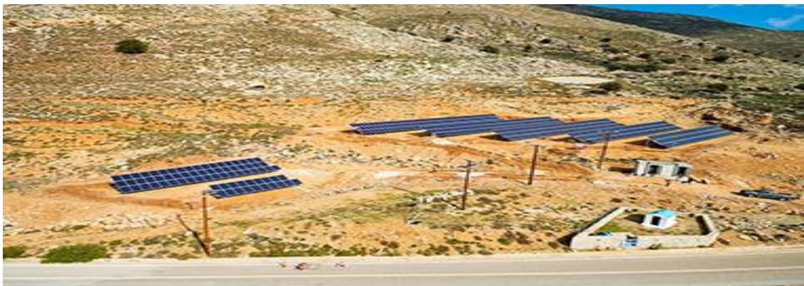
Εικόνα 4.5: S4S Project Tilos (Φωτοβολταϊκά) [39]
