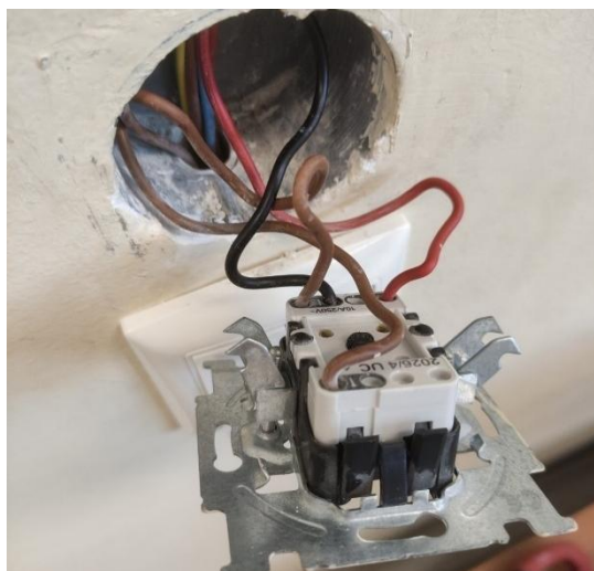
Εικόνα 9: Η καλωδίωση πίσω από τον ένα διπλό διακόπτη των δυτικών σκιάστρων, με την προσθήκη επιπλέον φάσης (μαύρο καλώδιο).
