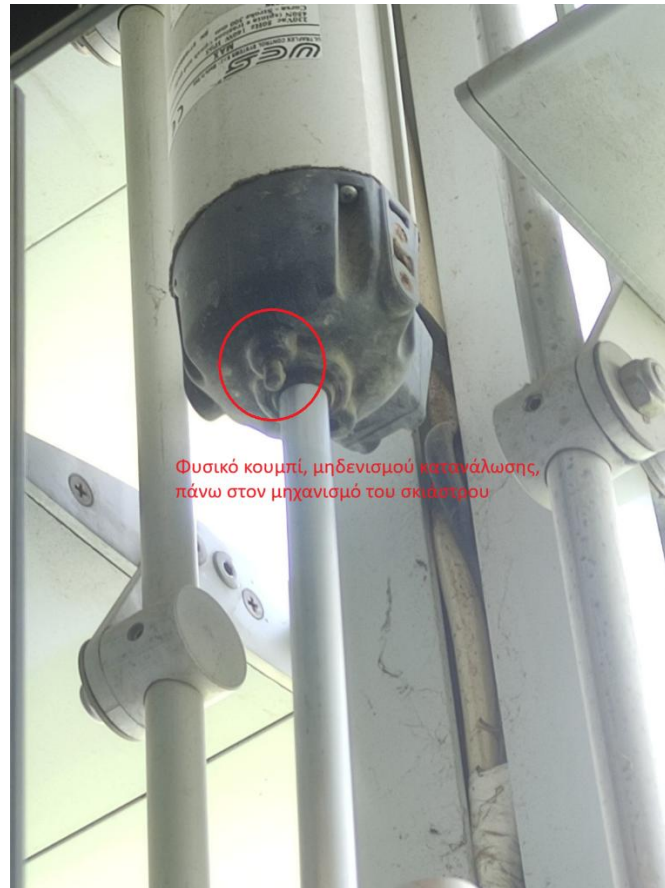
Εικόνα 16: Ένας από τους μηχανισμούς σκίασης, με επισήμανση του σημείου-κουμπιού μηδενισμού ηλεκτρικής κατανάλωσης.
