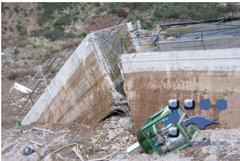
Εικόνα 1: Ολοσχερής καταστροφή Χ.Υ.Τ.Α Σάμου, από κατολίσθηση. https://geognosis.wordpress.com/wp-content/uploads/2012/05/xyta.jpg
