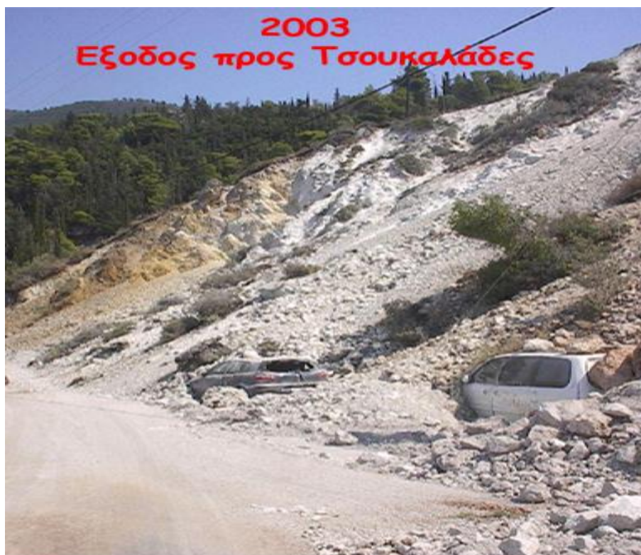
Εικόνα 21: Αστοχία πρανούς μετά από σεισμό στη Λευκάδα, έτος 2003.
