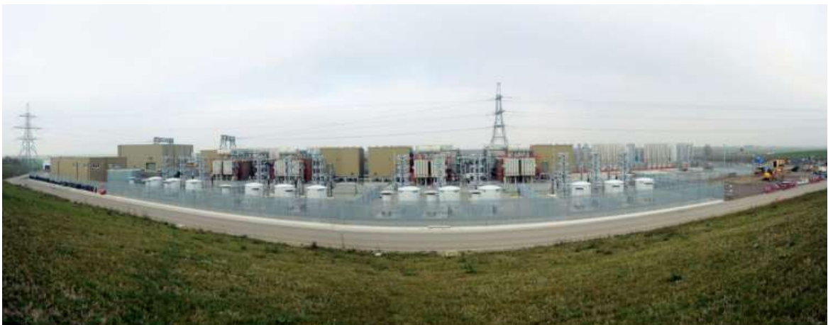
Εικόνα 5.9: Υποσταθμός Cleve Hill (2)
