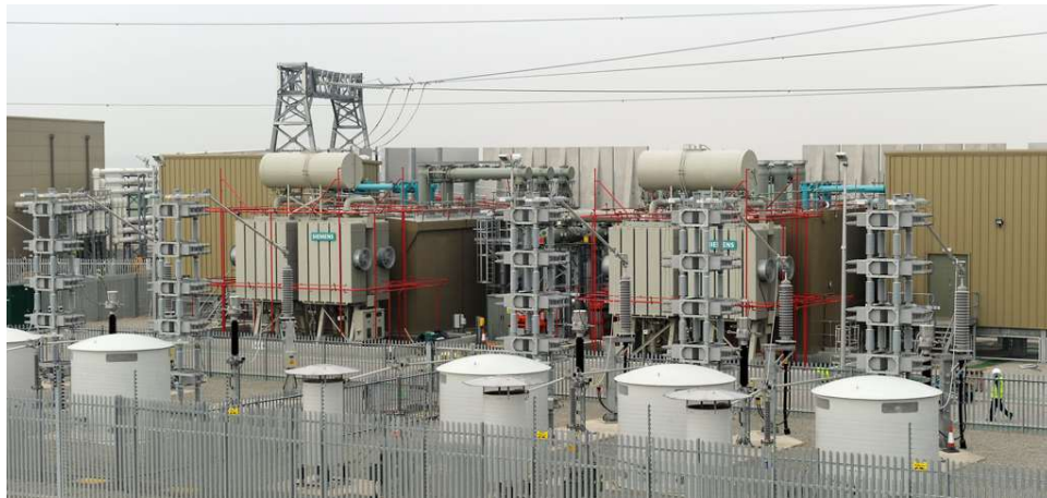
Εικόνα 5.8: Υποσταθμός Cleve Hill (1)
