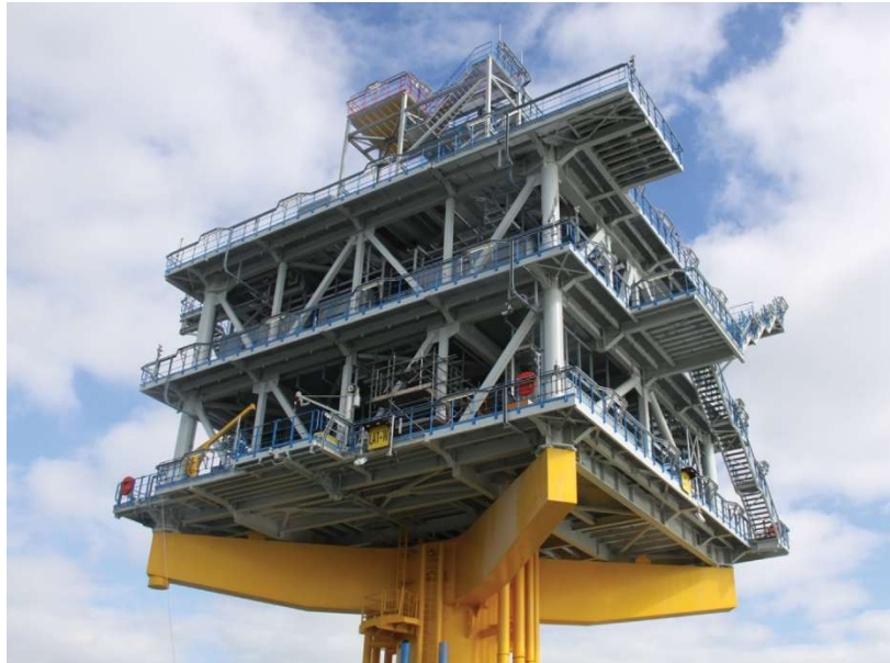
Εικόνα 5.5: Πλήρως εγκατεστημένος υποσταθμός του London Array
