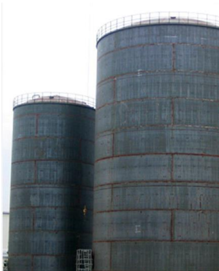
Εικόνα 23: Ατμοσφαιρικές Δεξαμενές (Atmospheric Storage Tanks)
