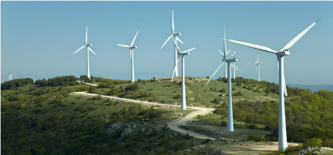
Εικόνα 4 Αιολικό πάρκο. (Πηγή: [4] )
