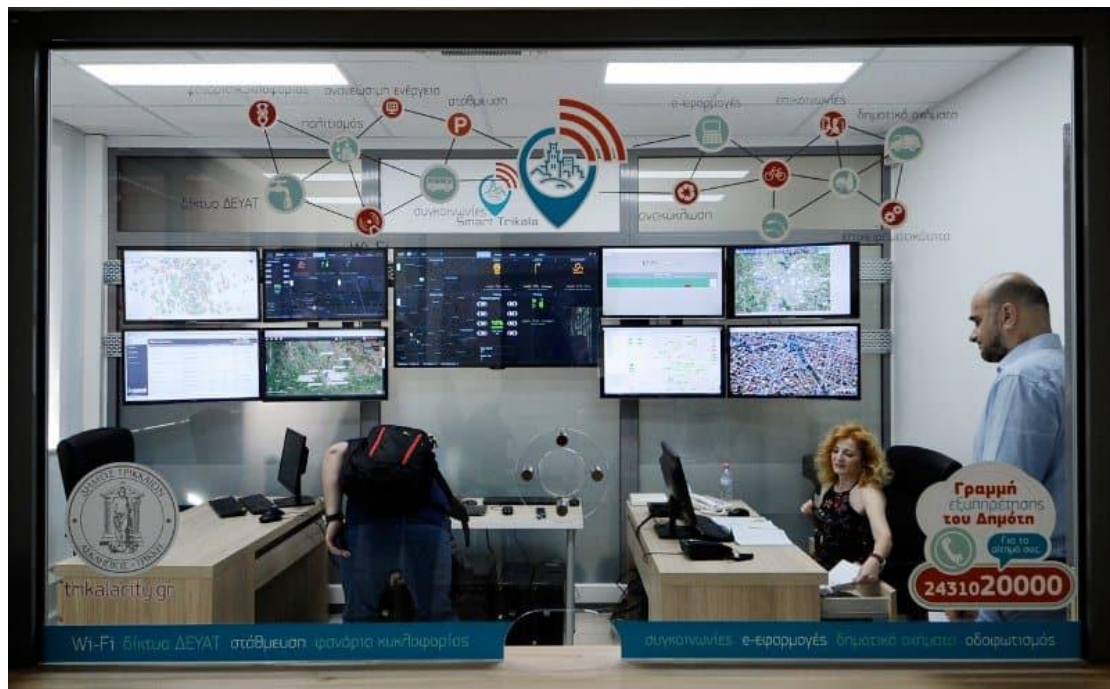
Εικόνα 20: Control Room- Δωμάτιο Ελέγχου
