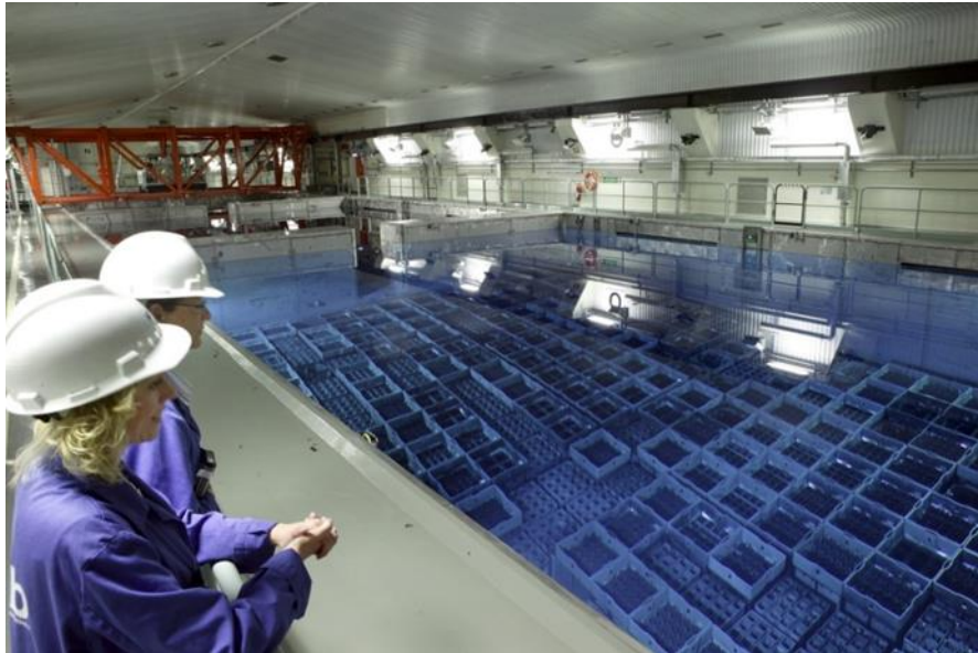
Εικόνα 25: Κεντρική Εγκατάσταση Ενδιάμεσης Αποθήκευσης σε δεξαμενή νερού, αναλωμένου καυσίμου (CLAB), Σουηδία. (πηγή: World Nuclear Association).
