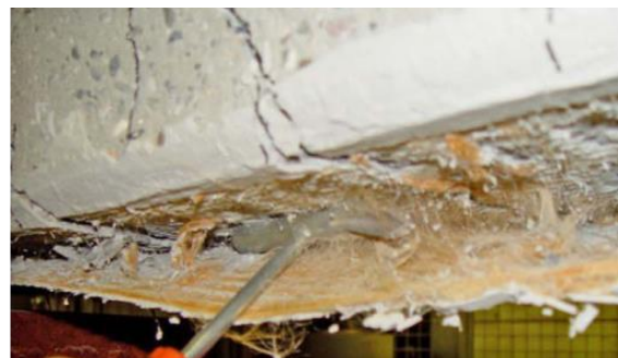
Εικόνα 10 : Αστοχία ΙΑΜ, 2 στρώσεις PBO
